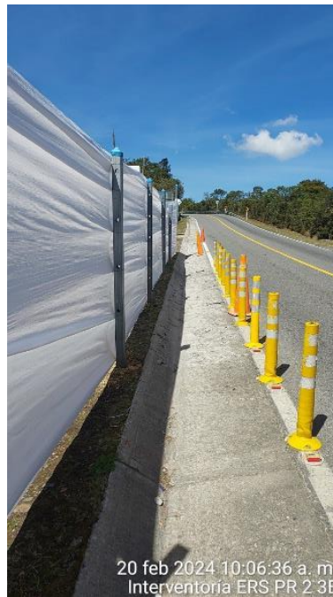
Ilustración 5 Costado derecho sentido Bogotá Choachí – con cuneta afectada por actividades de demolición.
