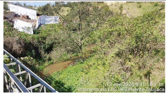
Ilustración 6 Estado actual del cauce del Rio Teusacá – Sentido Occidental B.
