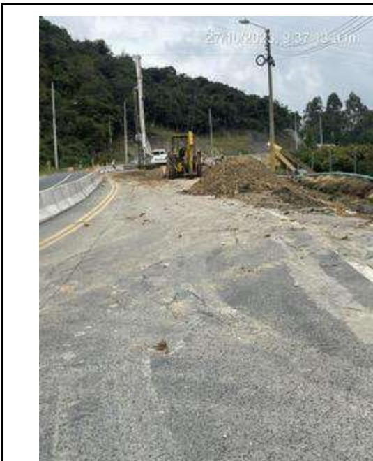
Ilustración 11 Área de trabajo sin señalización y demarcación, presencia de RCD.
