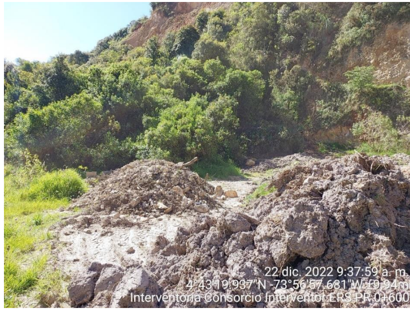
Figura 16 Sitio de acopio temporal y presencia de material para disposición, se denota la presencia de material orgánico y de excavación.
