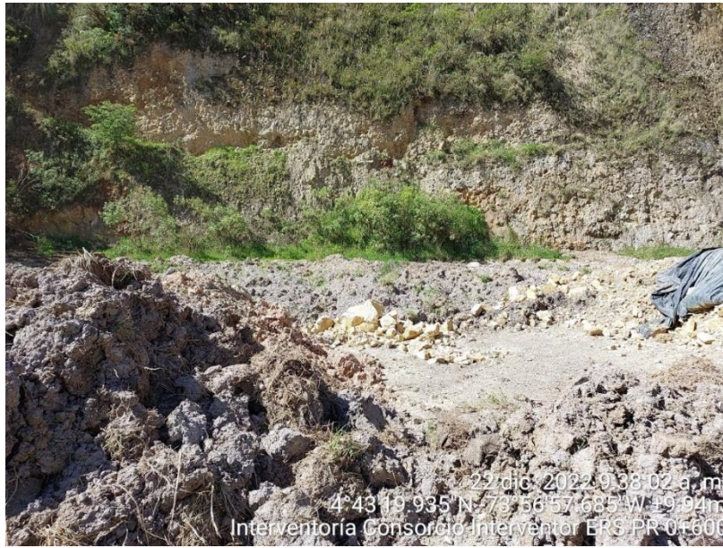
Figura 15 Sitio de acopio temporal y presencia de material para disposición, se denota la presencia de material orgánico y de excavación
