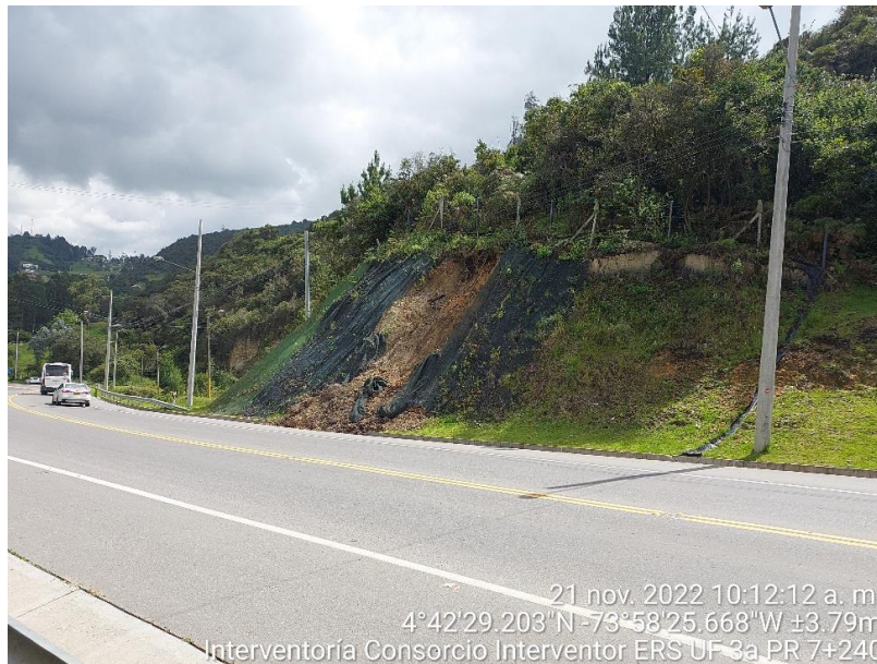
Figura 4-21 Presencia de material sobre la canal y vía (alud).
