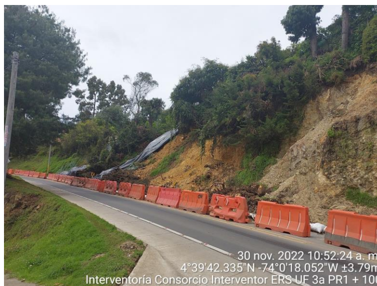
Figura 4-27 Estado actual del alud, material sobre el canal y calzada, presencia de barreras física y control de tráfico.
