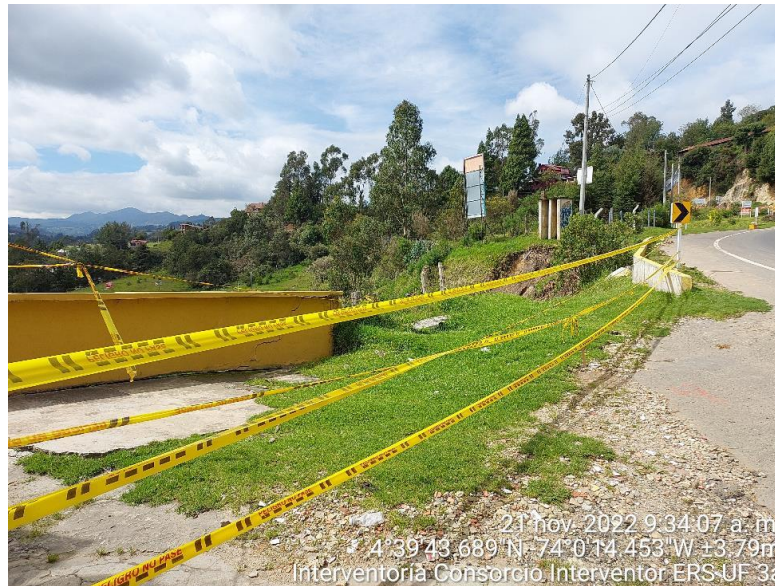
Figura 4-12 Evidencia de señalización en los puntos críticos. Presencia de agrietamiento en estructura de concreto.
