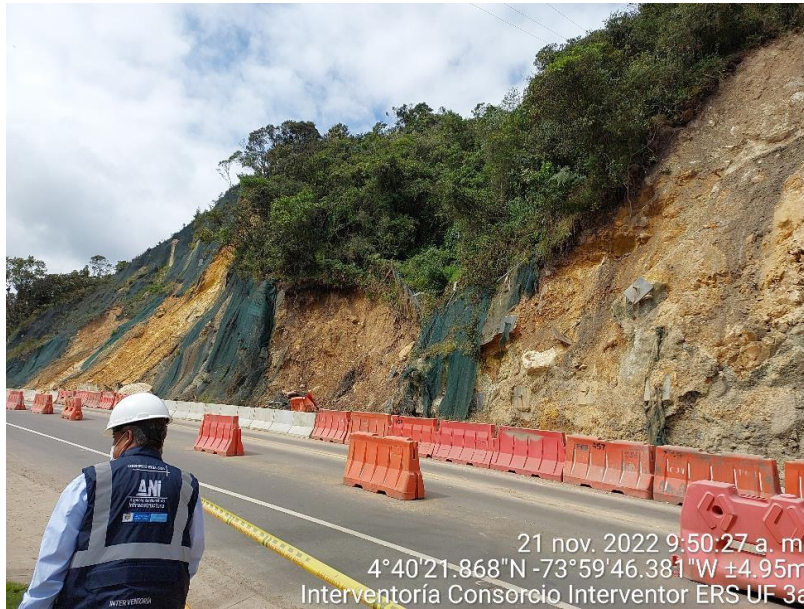
Figura 4-17 Señalización, Separadores físicos. Presencia de material sobre la canal y vía (alud). Restricción por un carril.
