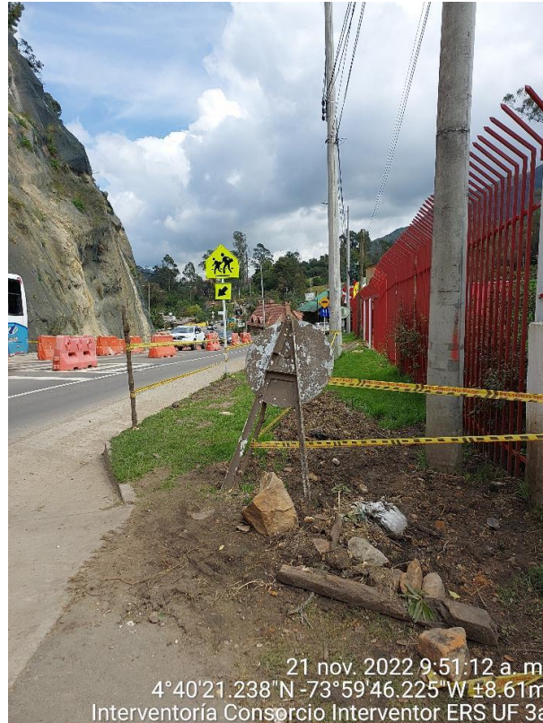
Figura 4-18 Señalización, Separadores físicos y paso peatonal provisional. Presencia de material sobre la canal y vía (alud). Restricción por un carril.
