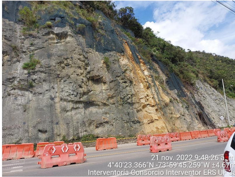
Figura 4-15 Señalización, Separadores físicos. Presencia de material sobre la canal y vía (alud). Restricción por un carril.
