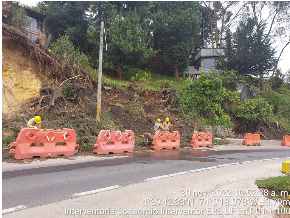
Figura 4-28 Estado actual del alud, material sobre el canal y calzada, presencia de barreras física y control de tráfico.
