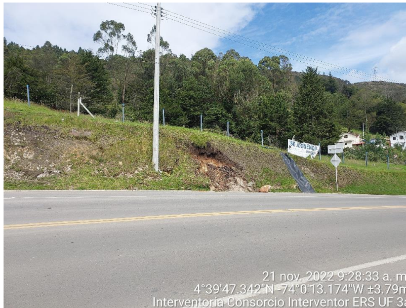
Figura 4-9 Presencia de material sobre las canales y berma (alud).
