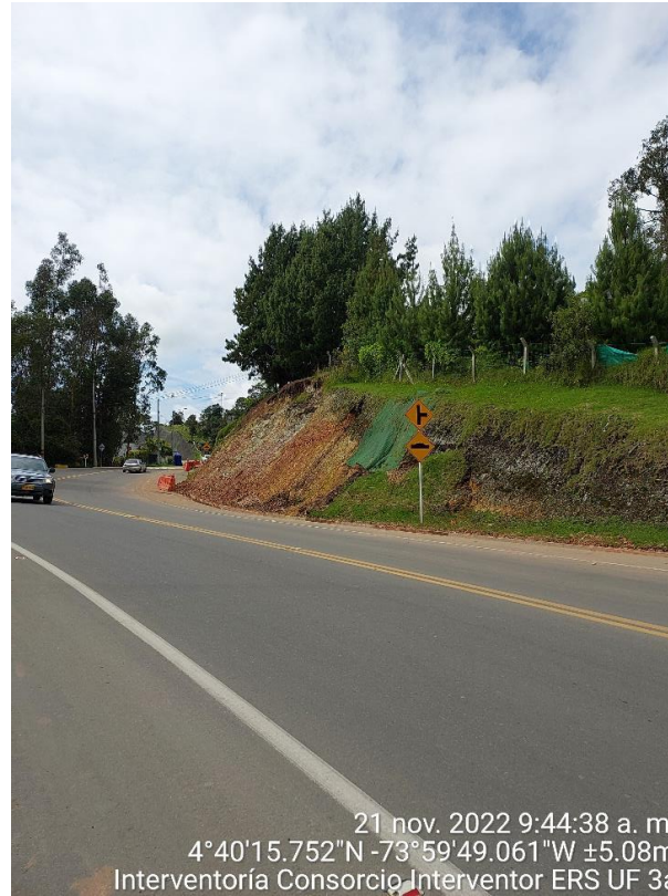
Figura 4-14 Evidencia de señalización y barreras mecánicas. Presencia de material sobre las canales (alud).
