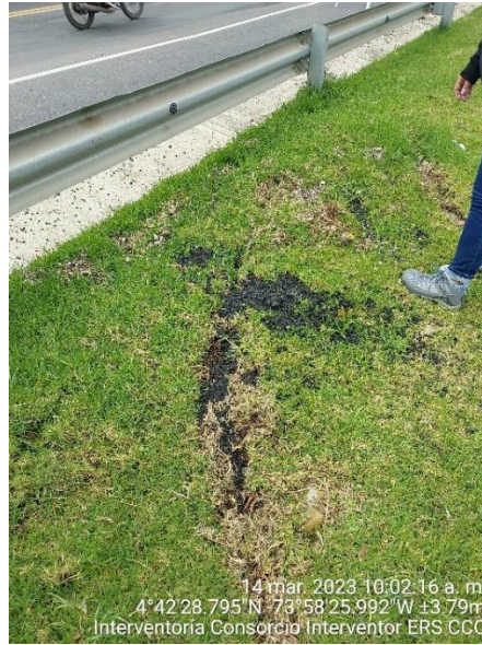
Figura 76 Área verde contaminada con asfalto de las obras adelantada.
