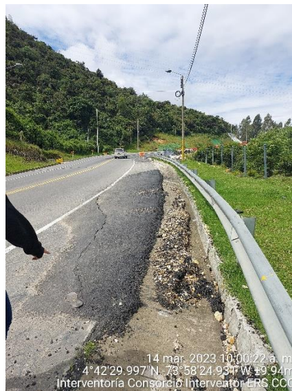
Figura 75 Presencia de residuos de Construcción de material pétreo y asfalto en cuneta del vial
