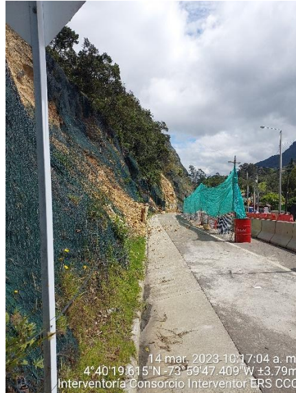
Figura 79 Área de prevención por falla de talud.
