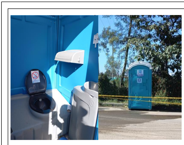
FOTOGRAFÍA N° 25 FECHA: 5-nov.-21 DESCRIPCIÓN UF1, Accenorte: Baños portátiles disponibles en calzada occidental (RN 5501 PR3+650)
