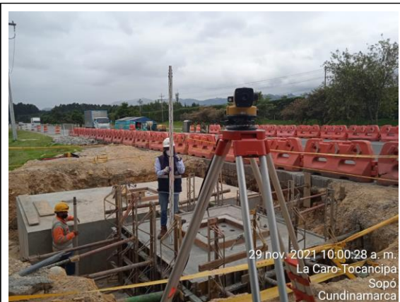
FOTOGRAFÍA N° # F FECHA: 29-nov.-21 DESCRIPCIÓN Levantamiento topográfico y verificación de niveles para Dado Columna C-5, Punete peatonal Aposentos, Costado oriental.
