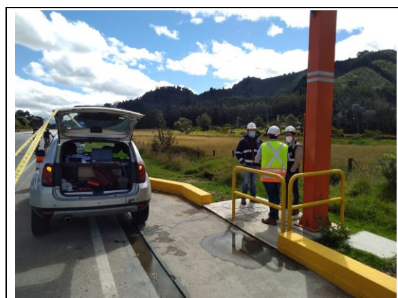
FOTOGRAFIA N° 0010 FECHA: 15/07/2021 Verificación a Redes Fibra óptica en postes SOS
