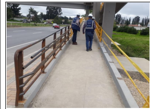
FOTOGRAFIA N° 0019 FECHA: 17/07/2021 Puente Peatonal La Diana, instalación de barandas en rampa margen Oriental
