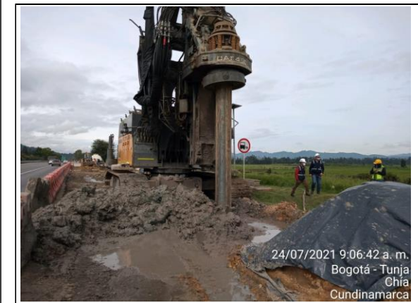
FOTOGRAFIA N° 0027 FECHA: 24/07/2021 U.F.4, labores de perforación pilote S1, puente peatonal Ladrillera, calzada occidental
