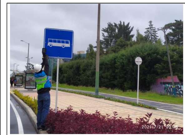
FOTOGRAFIA N° 0021 FECHA: 21/07/2021 RN 45A04 El Buda - La Caro. Acompañamiento a medición de indicador E11 Señalización vertical - medición semestral
