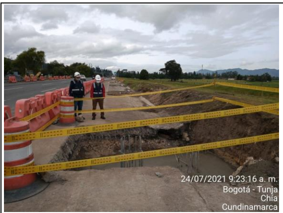
FOTOGRAFIA N° 0028 FECHA: 24/07/2021 U.F.4, fundida solao, dado módulo de inicio, pilotes adicionales, puente peatonal Pricemart, calzada occidental
