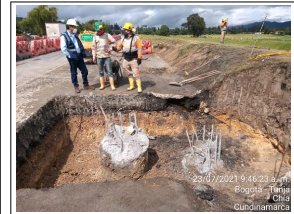
FOTOGRAFIA N° 0025 FECHA: 23/07/2021 U.F.4, labores de descabece de pilotes adicionales dado módulo de inicio, puente peatonal Pricemart, calzada occidental
