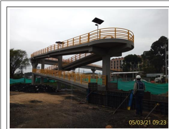
FOTOGRAFÍA N° 0005 FECHA: 5/03/2021 Puente peatonal Universidad de Cundinamarca, seguimiento de Interventoría a los trabajos de soldadura en barandas.
