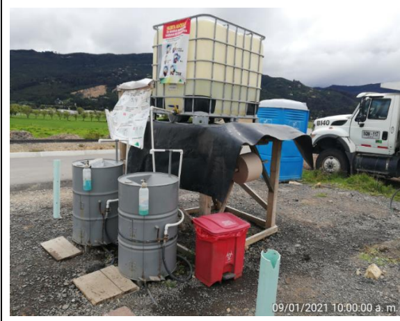
FOTOGRAFÍA N° 37 FECHA: 9-ene.-21 DESCRIPCIÓN UF3, Sector de Cuernavaca - Punto de lavado de manos Mincivil
