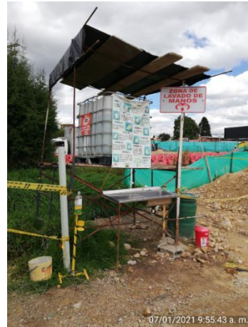
FOTOGRAFÍA N° 40 FECHA: 7-ene.-21 DESCRIPCIÓN UF3, Sector Húmero - Punto de lavado de manos del personal de INDEG
