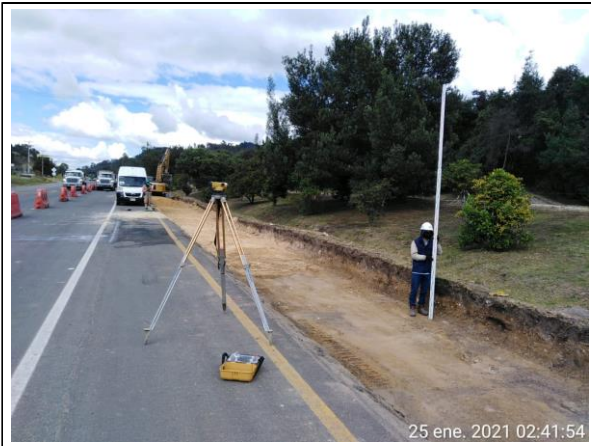
FOTOGRAFÍA N° FECHA: 25-ene.-21 DESCRIPCIÓN Toma de secciones transversales en ampliación de vía zona Puente Peatonal Tinjacá Yerbabuena.
