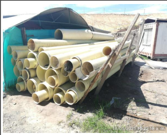
FOTOGRAFÍA N° 11 FECHA: 18-ene.-21 DESCRIPCIÓN UF3, Sector humero: condición insegura por estacas que sostienen la tubería, ya se encuentran inclinadas y por peso podría causar la caída de las mismas
