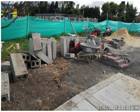
FOTOGRAFÍA N° 7 FECHA: 27-ene.-21 DESCRIPCIÓN UF4, Puente peatonal ubicado la universidad Manuela Beltrán: En constado oriental se evidencia acopio de bordillos de manera insegura, la posición es vertical y se encuentran inestables por la superficie, esta condición podría causar la caída y posible lesión al personal que transite por la zona
