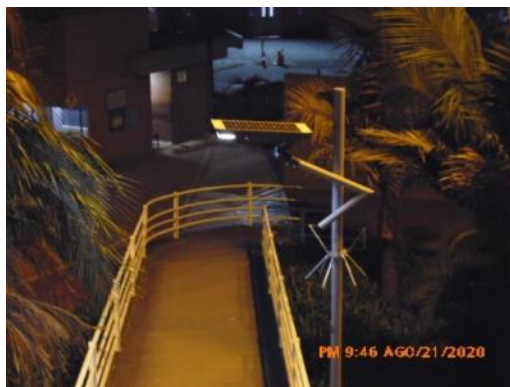
Panel FV sobre el que incide la luz proveniente de la luminaria del mástil.
