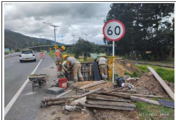
FOTOGRAFÍA N° 0014 FECHA: 15/11/2023 K4+760 seguimiento a actividades de encofrado para construcción caja descole, red alcantarillado, sector Series.
