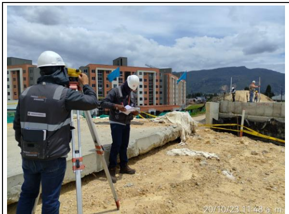
FOTOGRAFÍA N° 0008 FECHA: 20-oct.-23 DESCRIPCIÓN Control de Asentamientos para placas superiores, en Box Couvert 1 y 2 Unidad Funcional No 3.
