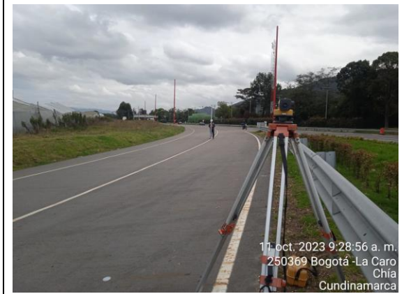
FOTOGRAFÍA N° 0004 FECHA: 11-oct.-23 DESCRIPCIÓN Verificación de niveles actuales de asfalto entre abscisas del K0+130 al K0+430 Ramal de Entrada y empalme Calzada Norte (Unidad Funcional No 3,
