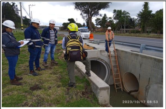
FOTOGRAFIA N° 0008 FECHA: 17/10/2023 Inspección conjunta entre Interventoría y Concesionario con experto de ARL Positiva para validación condiciones de tubería y conceptos legales sobre trabajos en espacio confinado.
