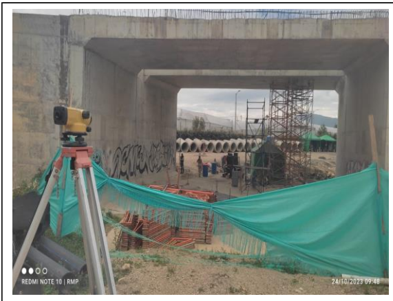
FOTOGRAFÍA N° 0009 FECHA: 24-oct.-23 DESCRIPCIÓN Control de asentamientos en placas inferiores de Box Coulvert 1 y 2 Intersección Húmero UF3.
