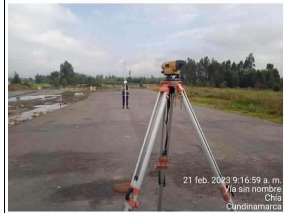
FOTOGRAFÍA N° 0010 FECHA: 21-feb.-23 DESCRIPCIÓN Nivelación para control periódico de asentamientos sobre zona de geobloques, calzadas Norte y Sur, entre abscisas K1+695 al K1+800, Unidad Funcional
