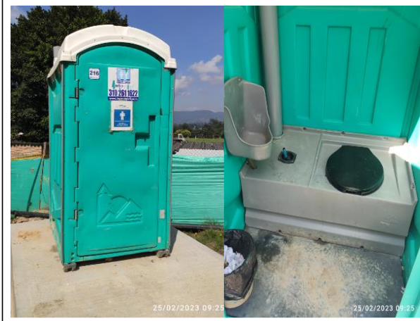
FOTOGRAFÍA N° 11 FECHA: 25-feb.-23 UF1, K1+390 costado occidental: Baño portátil con lavamanos (Accenorte)
