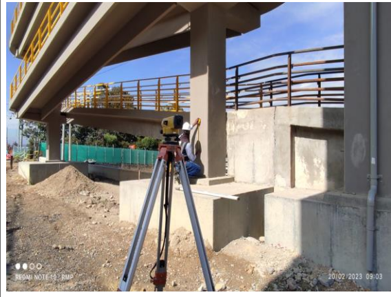
FOTOGRAFÍA N° 0009 FECHA: 20-feb.-23 DESCRIPCIÓN Control de asentamientos en columnas, rampa Occidental y muro de contención de Puente Peatonal Olímpica carrera séptima Unidad Funcional No
