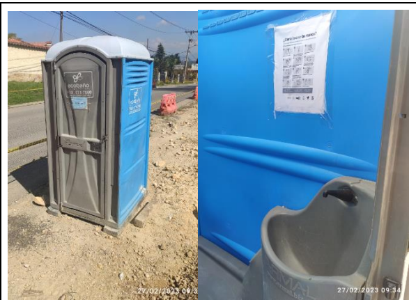
FOTOGRAFÍA N° 10 FECHA: 27-feb.-23 DESCRIPCIÓN UF1, K0+850 costado oriental: Baño portátil con lavamanos (Mincivil)
