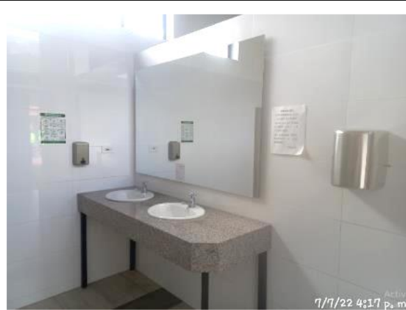
FOTOGRAFÍA N° 5 FECHA: 7-jul.-22 DESCRIPCIÓN UF2, Centro de Control Operacional: Punto de lavado de manos en baños públicos
