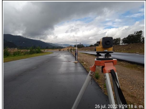
FOTOGRAFÍA N° 0010 FECHA: 26-jul.-22 DESCRIPCIÓN Control de asentamientos en zona de geobloques, entre abscisas K1+695 al K1+800, Calzadas norte y sur Unidad Funcional No 3.
