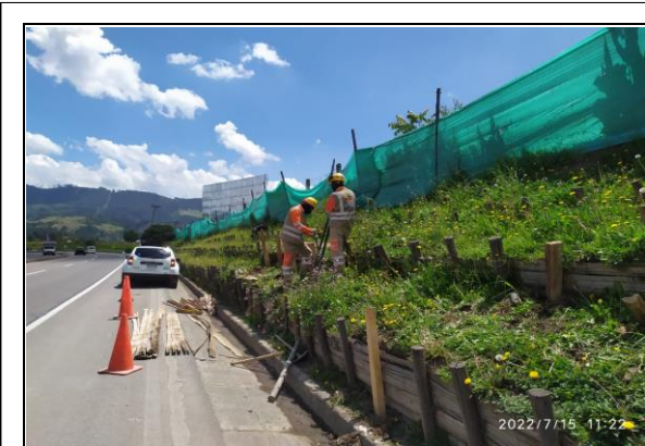
FOTOGRAFIA N° 0017 FECHA: 15/07/2022 Seguimiento desde el área de operación de interventoría RN 45ACNA PR5+500 Calzada Oriental. Mantenimiento de trinchos.
