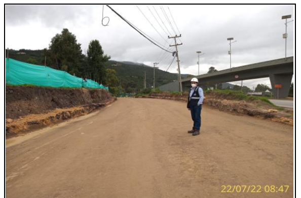
FOTOGRAFIA N° 0022 FECHA: 22/07/2022 U.F.1 Seguimiento a la instalación de material de Subbase primera capa calzada oriental sector Series.
