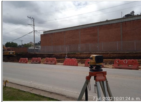
FOTOGRAFÍA N° 0004 FECHA: 7-jul.-22 DESCRIPCIÓN Verificación de niveles para excavación y pedraplén de estructura de vía entre abscisas K4+710 al K4+730, calzada derecha Unidad Funcional No 1.
