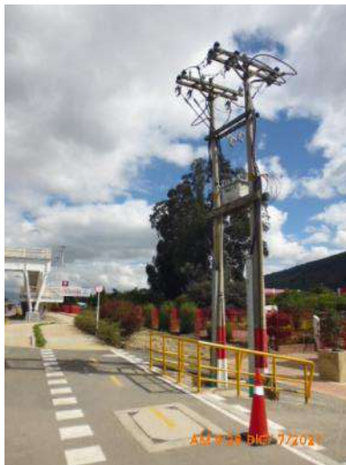
Transformador exclusivo de AP costado oriental UF2
