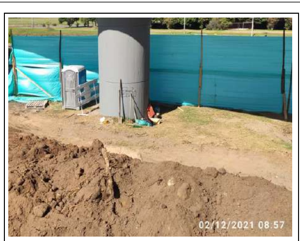
FOTOGRAFÍA N° 30 FECHA: 2-dic.-21 DESCRIPCIÓN UF1, Centro de acopio en sector La Caro: Baños portátiles disponibles
