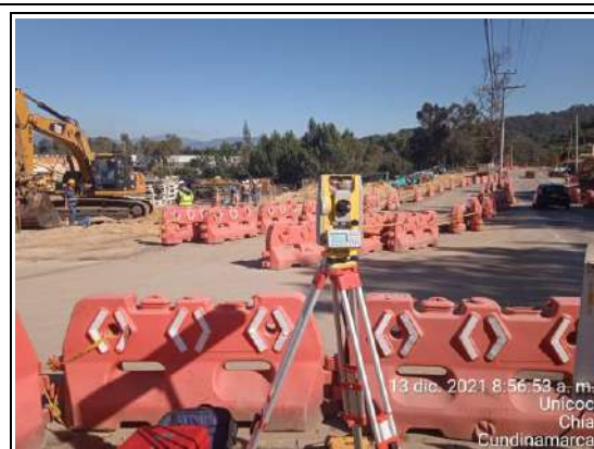
FOTOGRAFÍA N° 0008 FECHA: 13-dic.-21 DESCRIPCIÓN Levantamiento topográfico de pilotes para columna C2 Puente peatonal Olímpica. Unidad Funcional No. 1.
